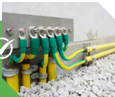
Ingeniería y provisión de CCM y ingeniería de sistema de puesta a tierra
